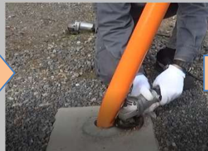
② (パイプ切断) 曲がったカーブミラーの根元をカットしカット面をきれいに仕上げます
